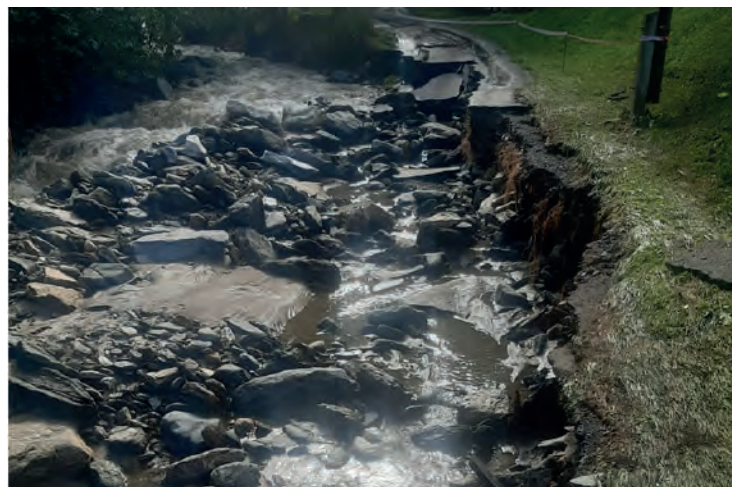
Pozůstatek asfaltové cesty po povodni. Foto: Bc. Jan Ťulpík
